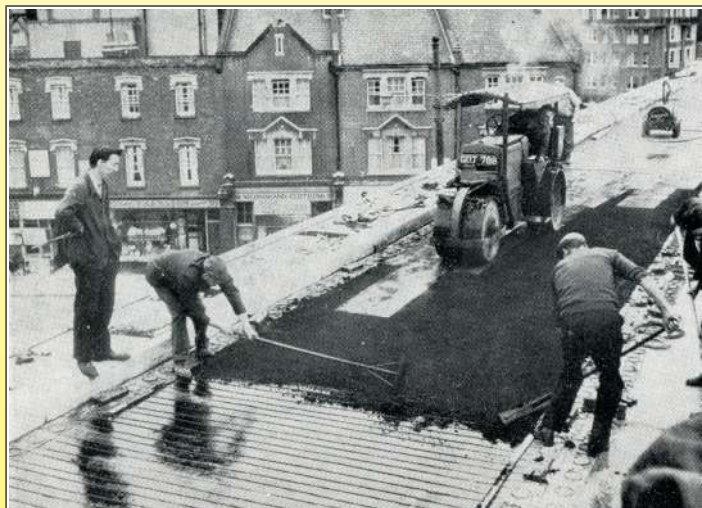
1969年在伦敦哈默施密特交叉路口的上面的行车道上铺设沥青。(道路的电供暖由罗伯特·费利克斯提供，1971年，Ultimheat博物馆*)
